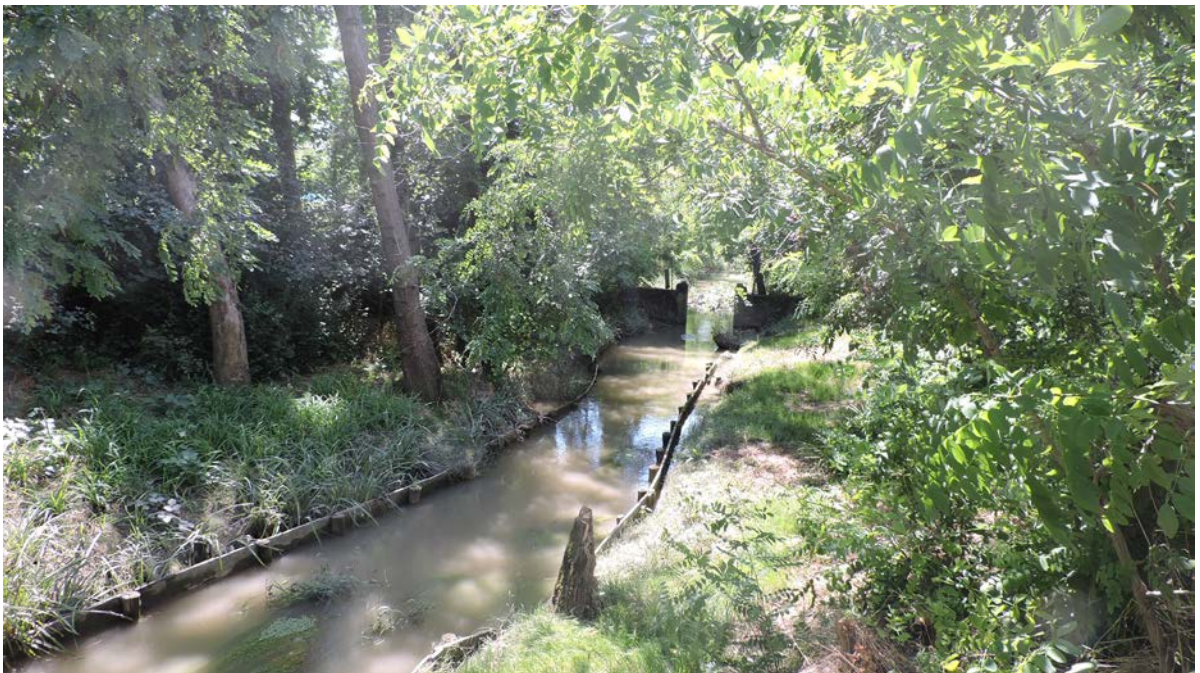
L'assito di protezione spondale, divelto in vari punti e scavalcato dal livello delle acque, oggetto di rifacimento e raccordo con la sponda. In aggiunta si prevede la rimozione del detrito accumulatosi al fondo in forma di fanghiglia.
