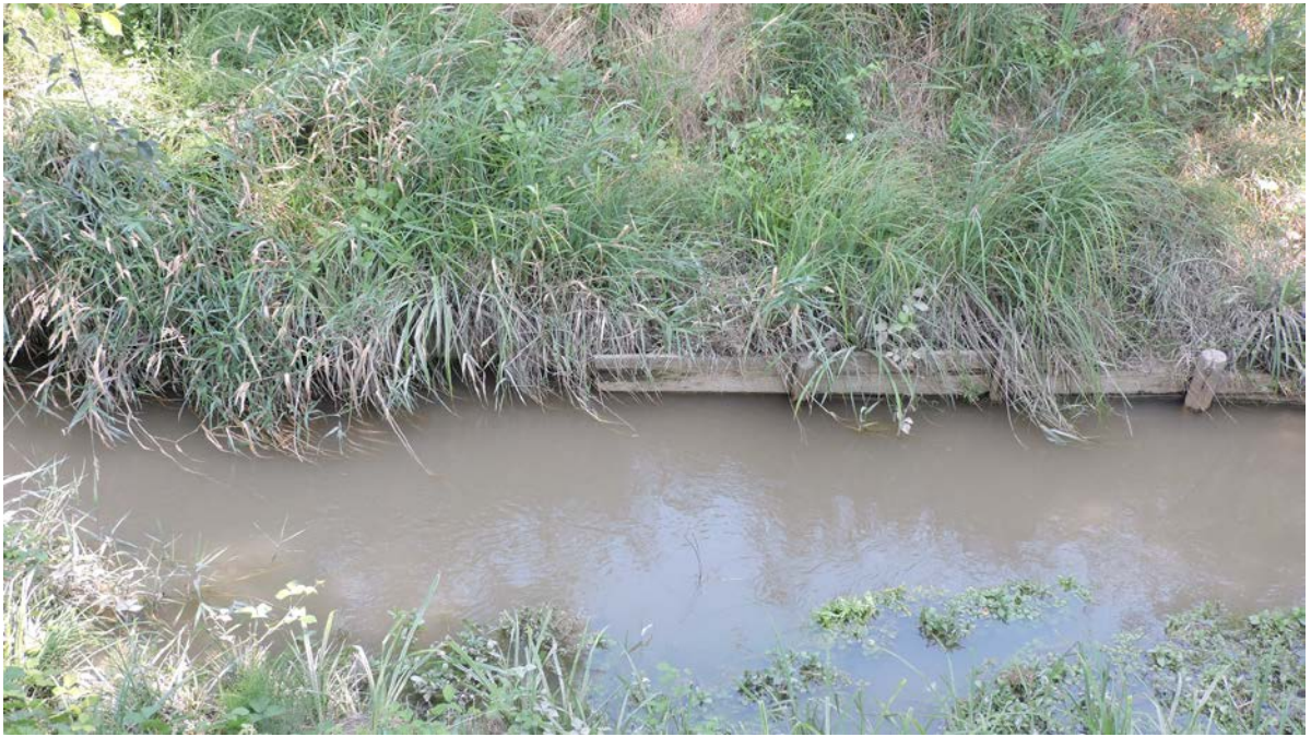
Assito rotto, da rimuovere e sostituire
