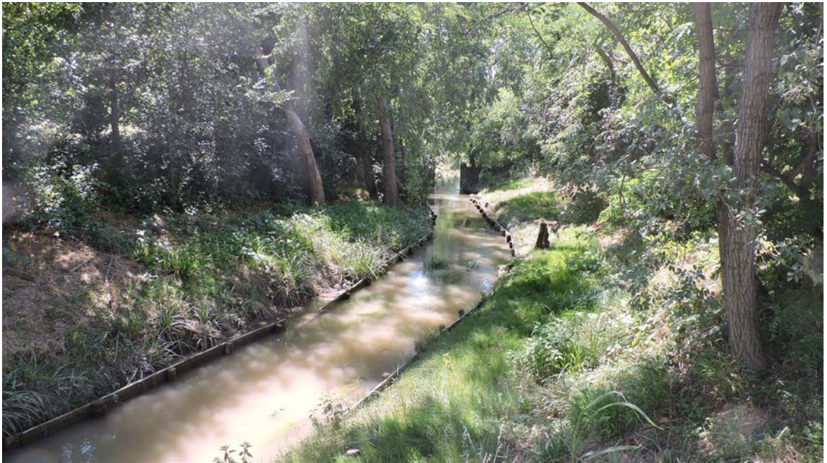
L'assito di protezione spondale, divelto in vari punti, oggetto di rifacimento
