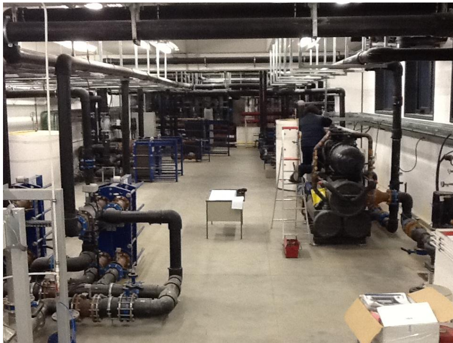
Centrale termica dello stabilimento Valsir di Vobarno
